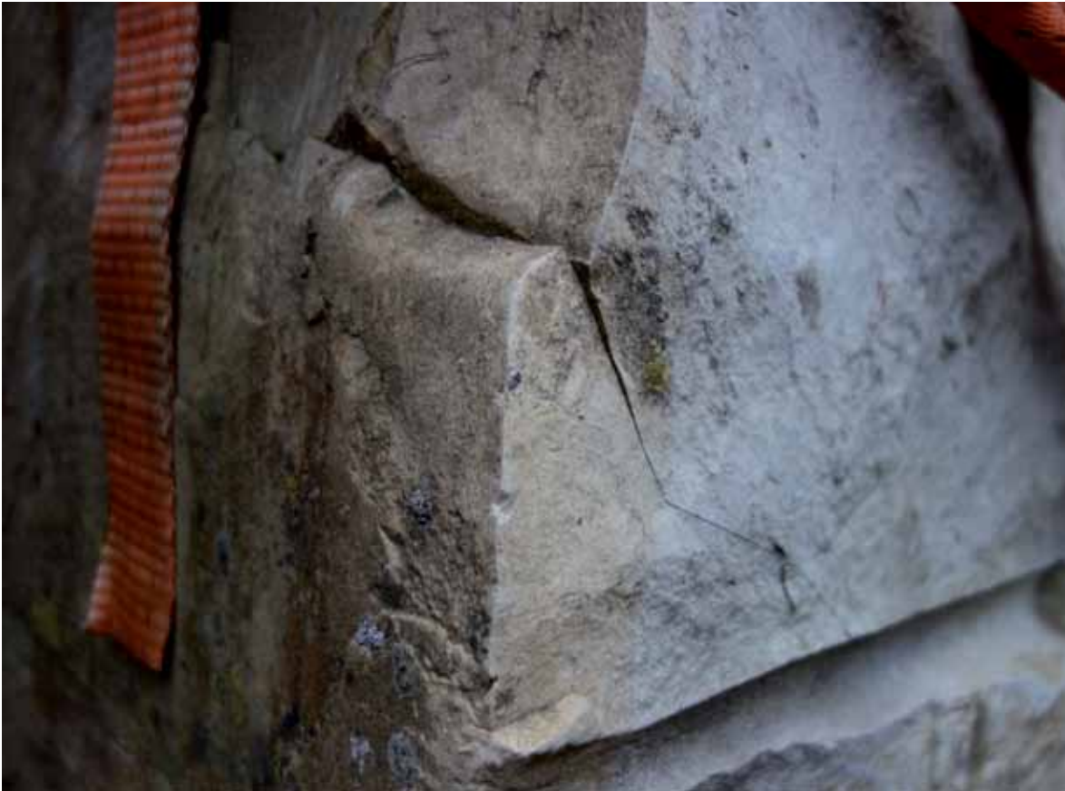
Erosie: scheuren verticaal.
