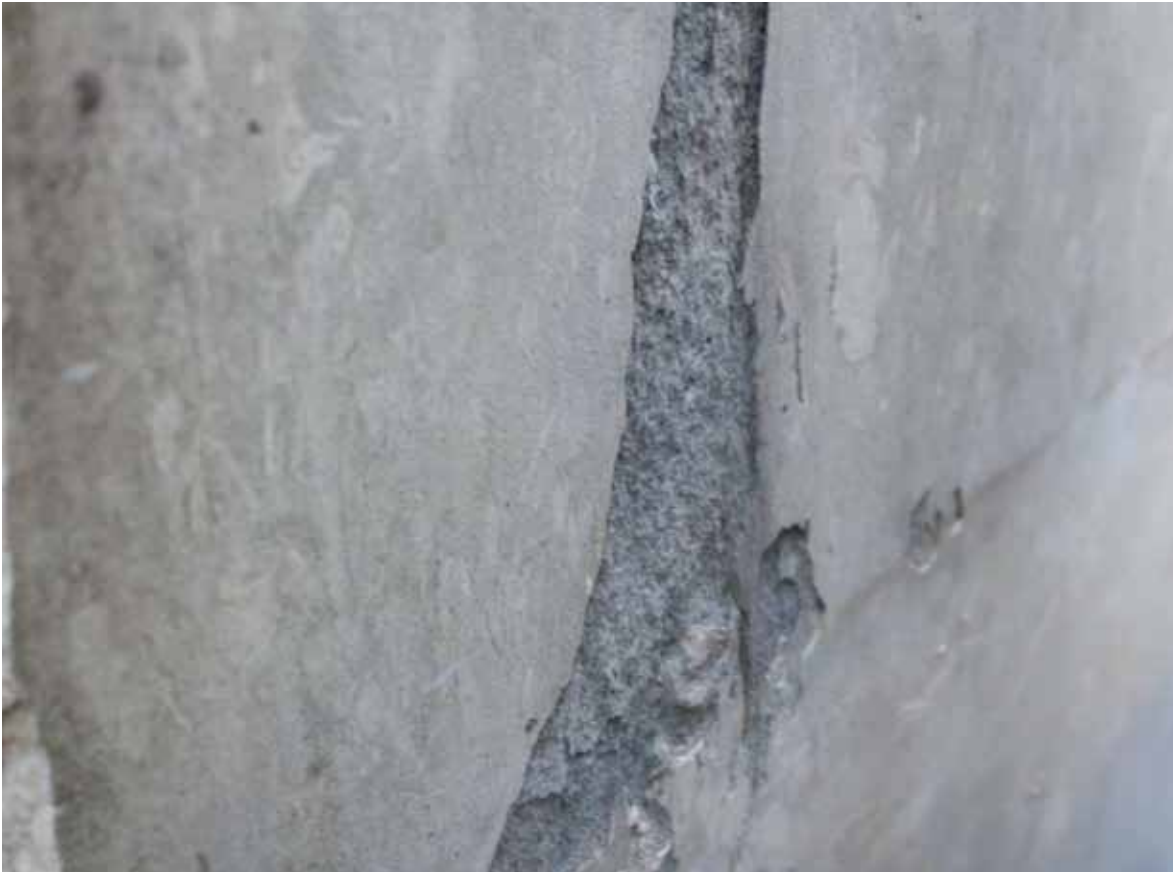
Erosie aan de oppervlakte: schilfering.
